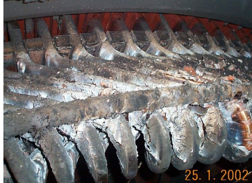
Fotografía del incendio del generador de Twin Falls
