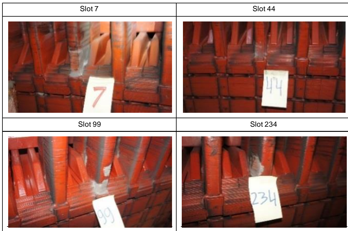
Figura 14. Evidência de atividades PD de superfície em quatro ranhuras diferentes da fase S
